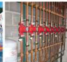
за отоплителни и климатични системи
